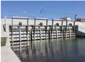
津波が発生した際、波の力によって扉が閉まり、川の上流域への遡上を防ぐフラップゲート。他にも避難タワーや避難道路などの整備も進められている。
